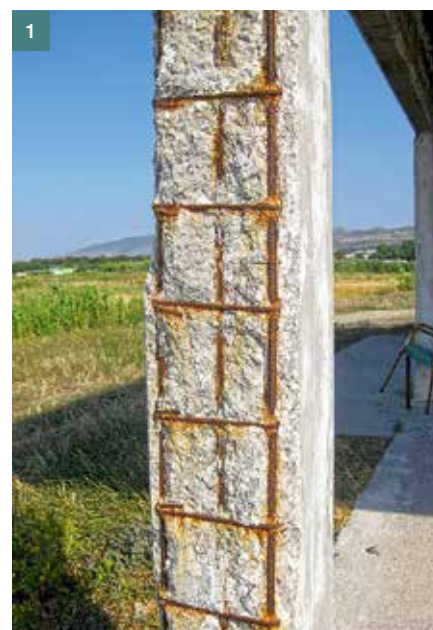
1 Ukázka působení aerosolu mořské vody: 200 m od pobřeží, ve směru převládajících větrů, nekvalitní beton bez údržby ■ 1 Example of seawater aerosol effect: 300 m distance from the seashore, in direction of prevailing wind, a low-grade concrete, no maintenance
