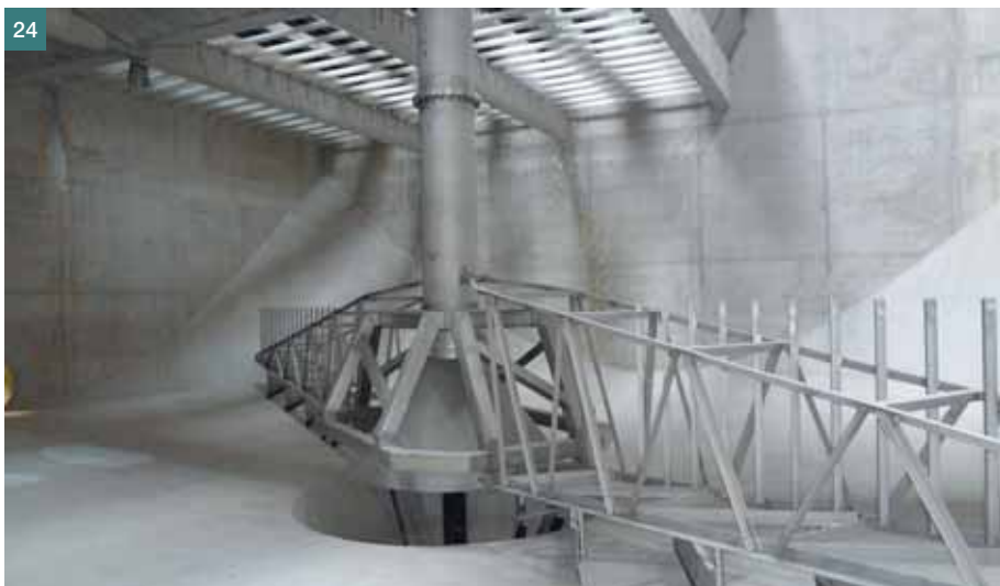
Obr. 24 Stírací most v nádrži Densadeg ■ Fig. 24 Bottom scraper system in the Densadeg tank
