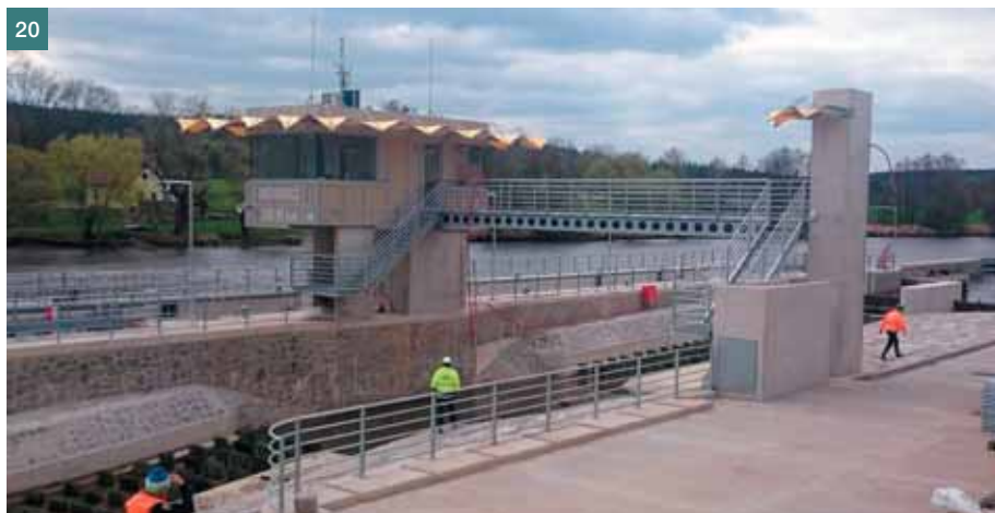
Obr. 16 Tvar betonových konstrukcí jezového pole ■ Fig. 16 Shape of the concrete structures of the weir
