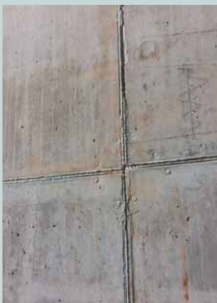
Obr. 6 Vada pohledového betonu: použití opotřebovaného bednění, chybné sesazení bednicích dílců a otisk nečistot a nákresu z bednění na povrch betonu
