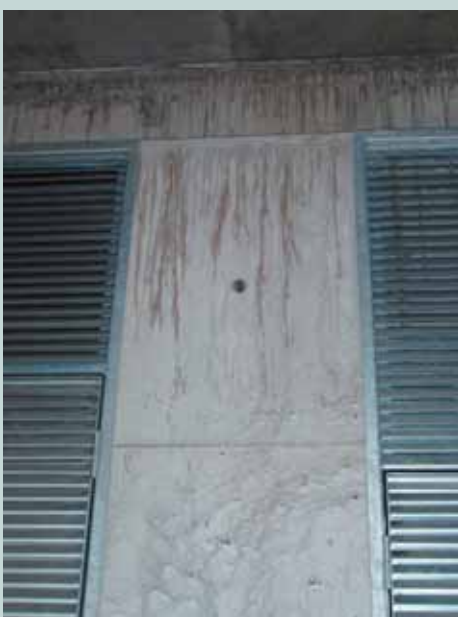
Obr. 5 Vada pohledového betonu: nedostatečně ztuhlý beton (v dolní části), krvácení betonu a zatečení cementového tmele na povrch betonu předchozího záběru
